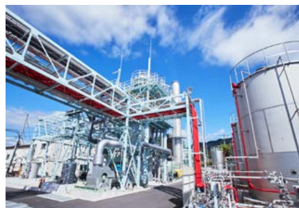
柳井本社工場 液中燃焼設備（新設）
