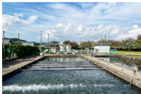
武生工場排水処理設備
