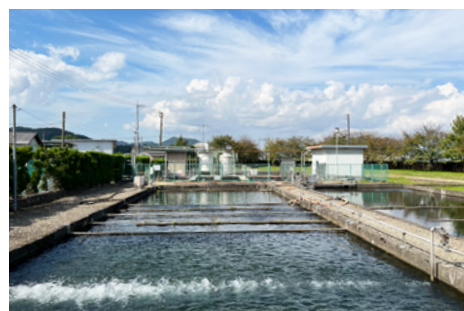
武生工場排水処理設備
