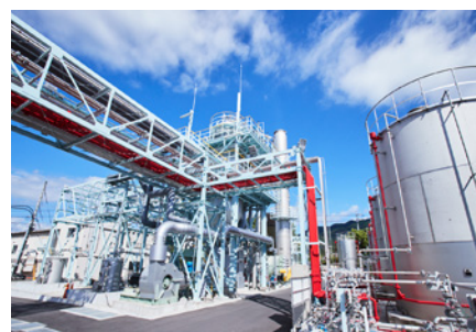
柳井本社工場 液中燃焼設備（新設）
