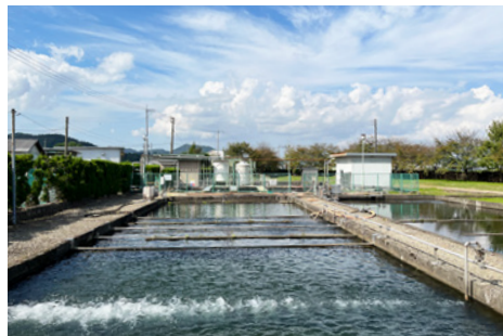
武生工場排水処理設備
