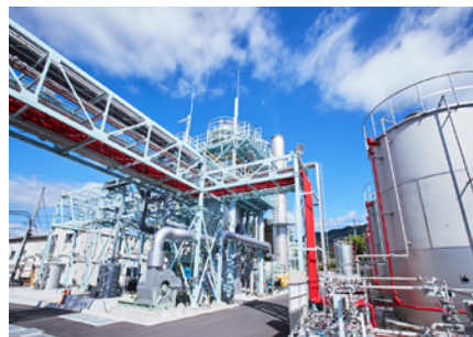
柳井本社工場 液中燃焼設備
